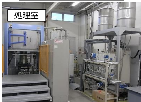
過熱水蒸気処理装置 1
